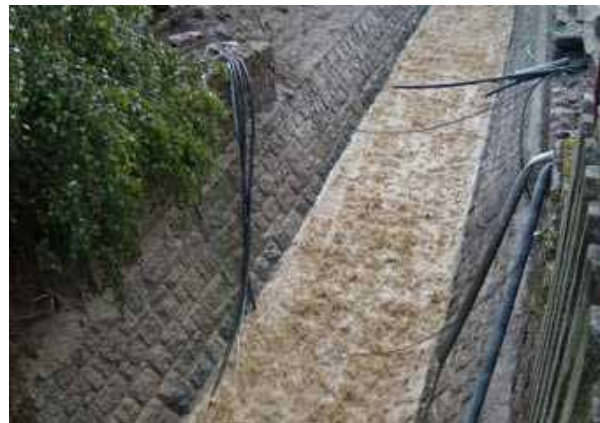
Zerstörte Kabel in Jerzens (Pitztal)
